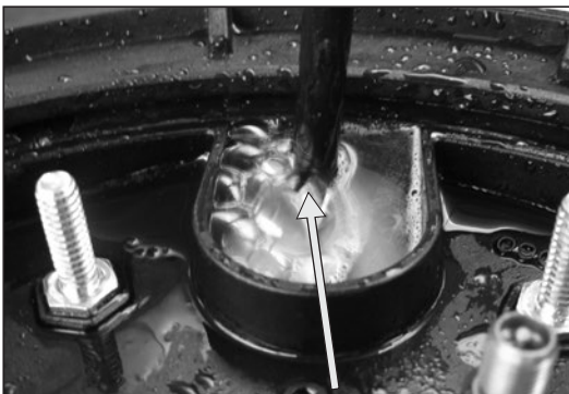
Fuga en la entrada del cable
