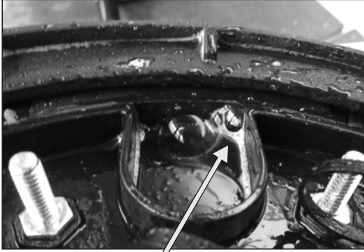
Fuga en la esquina del puerto de entrada
